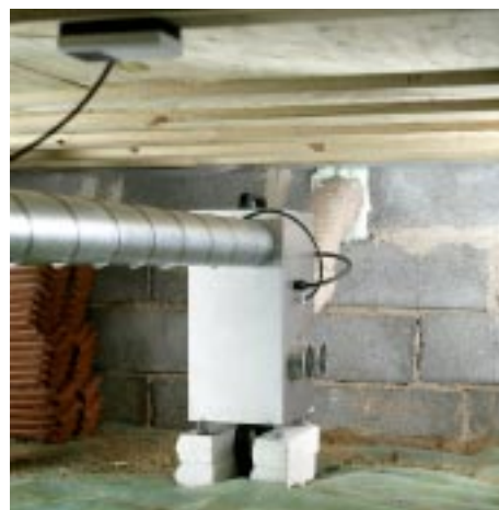
En avfuktare från Seibu Giken DST installerad i krypgrund. Avfuktaren kan även monteras hängande på väggen.
